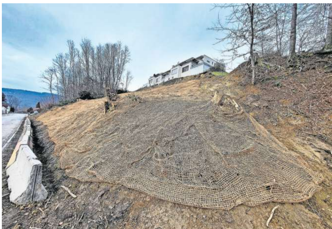
Der Kanton hat das abgerutschte Material aus dem Hang entfernen lassen.
